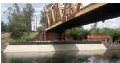
Canal de Igarapé – Reforço da proteção dos pilares da margem direita concluído
