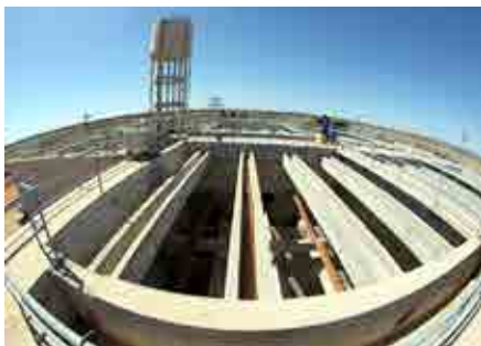
Estação de Tratamento de Águas
